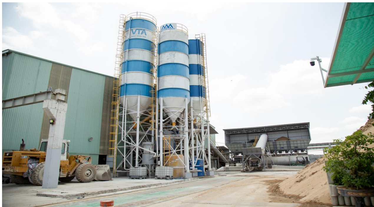
Silo trạm trộn
